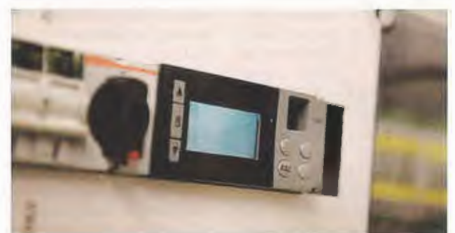
Poistoilman ohjauskeskus lisättiin viimeisimmässä älyremontissa.
