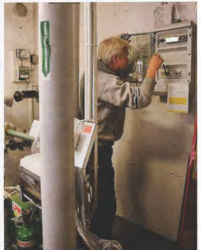
Oumanin myynnin tekninen tukihenkilö Kari Heikkilä tutkii Outflex-säädintä sekä langattoman mittausjärjestelmän tukiasemaa talon lämmönjakohuoneessa.
