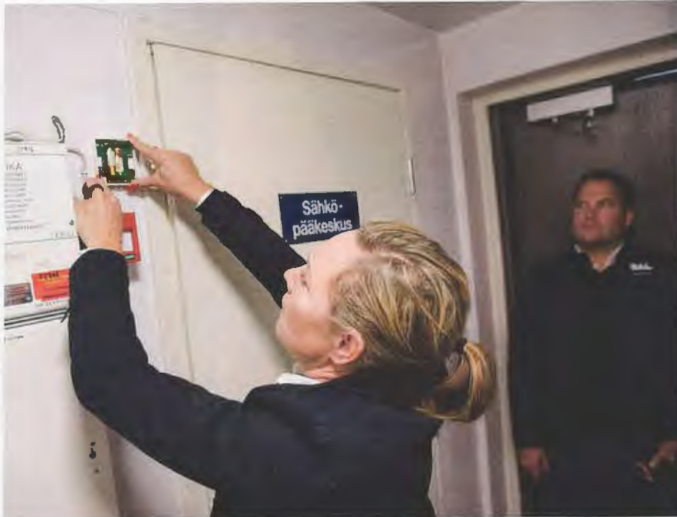
Oumanin asiakaspäällikkö Marika Kirsilä kiinnittää langatonta kosteuslämpötila-anturia seinään kaksipuoleisella teipillä sähköpääkeskuksen viereen 1990-luvun talossa. NAL Asuntojen toimitusjohtaja Samuli Killström on tehnyt Oumanin kanssa yhteistyötä vuosia.
