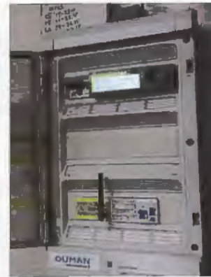
Oumanin järjestelmä säätää ensin ilmamäärät kohdalleen, ja vasta sitten on aika säätää lämpötilat sopiviksi.
